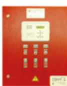
ШАК Шкаф аппаратуры коммутации
